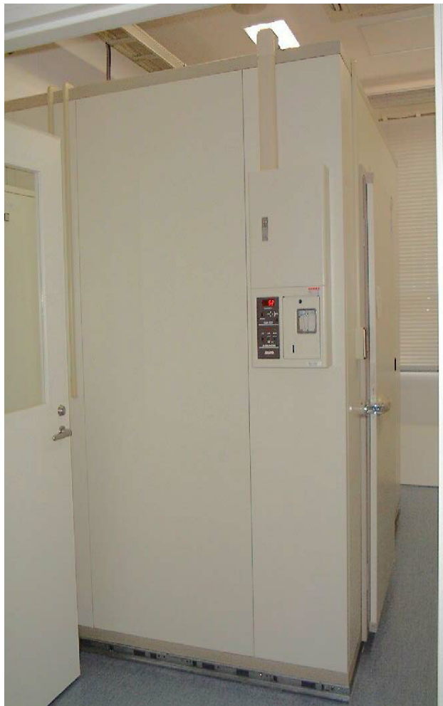
写真 10 資料分析室 3 に設置されているコールドルーム（タンパク質結晶成長用）
